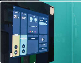
2 Панель управления инженерными системами
