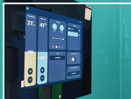
2 панель управления инженерными системами
